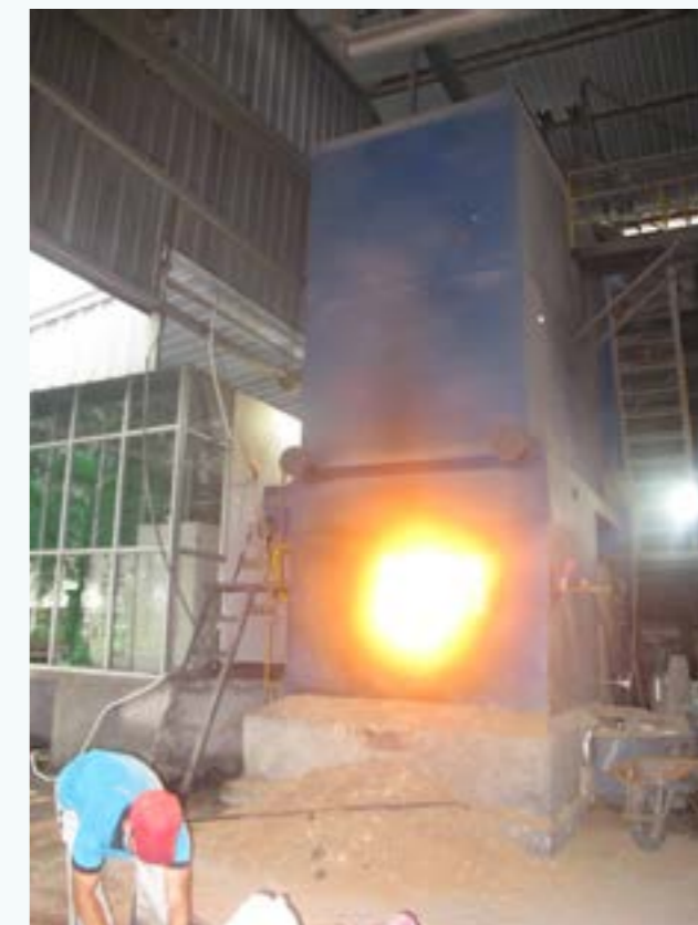
Ảnh: Lò hơi tầng sôi đốt sinh khối tại HT Vina. Nguồn: VNCP.
