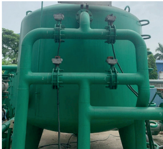
Bể tái chế nước thải hiện tại
