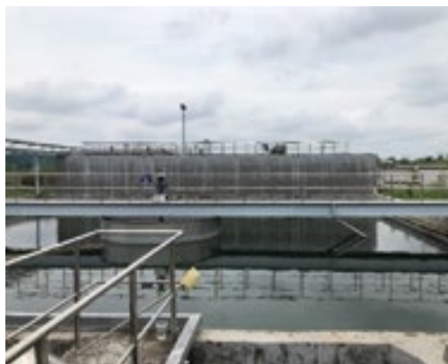
Hệ thống xử lý nước thải tại KCN Xuyên Á
