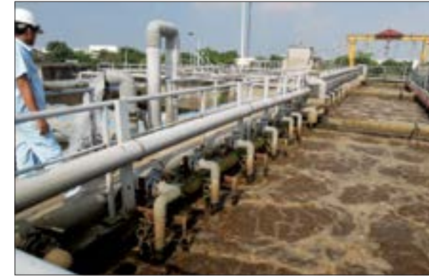
Hệ thống xử lý nước thải tập trung sử dụng màng lọc và công nghệ vi sinh của KCN Thăng Long
