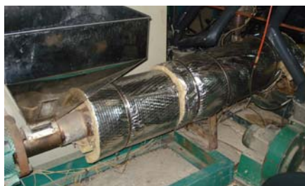
Thiết bị đã được bảo ôn phù hợp sau tư vấn CP-RE
