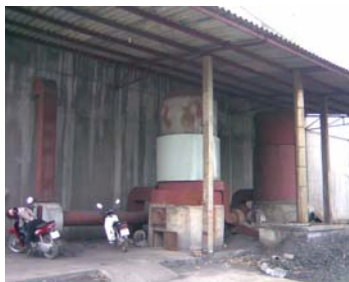
Hệ thống cấp khí nóng trước SXSH: 2 lò hiệu suất kém
